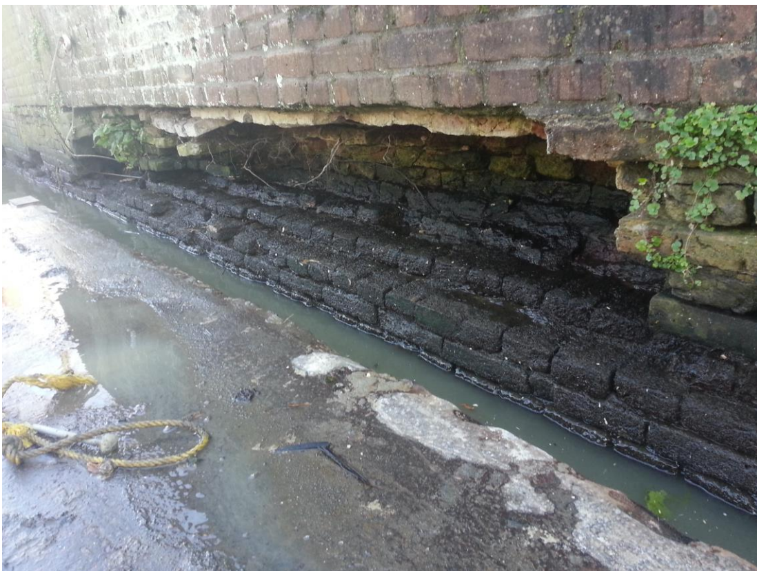
Foto 2: Een van de grotere gaten in de kademuur
