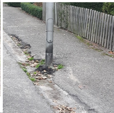
Lichtmast in slecht asfalt: wenselijk om gelijktijdig te vervangen
