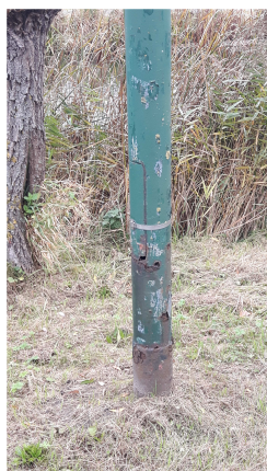
Lichtmast in slechte staat
