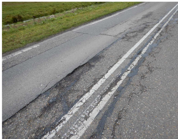
Asfaltschade Mariahoeveweg, inmiddels gerepareerd
