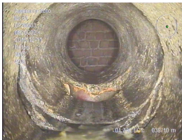
Riool Tesselschadelaan: breuk en aantasting van leidingen
