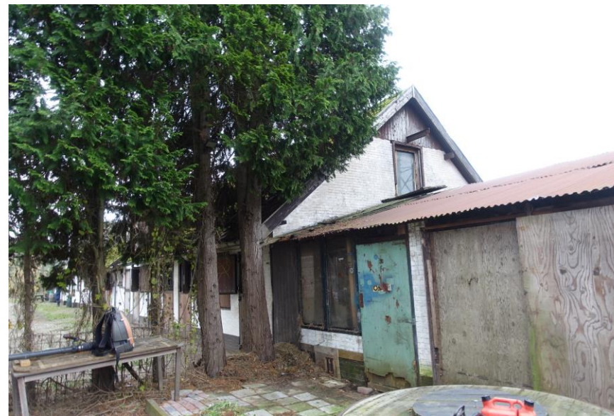
Franse Kampweg 30 A-C. De westelijke topgevel. FH MAB 24-11- 2020
